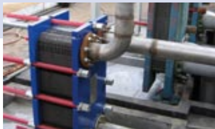
Vgrajen novi izmenjevalec toplote
