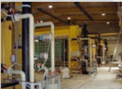
Štiri filter stiskalnice po montaži
