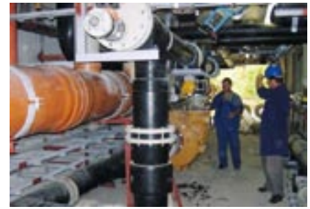
Strojna oprema črpalke za suspenzijo v tehnološkem hodniku
