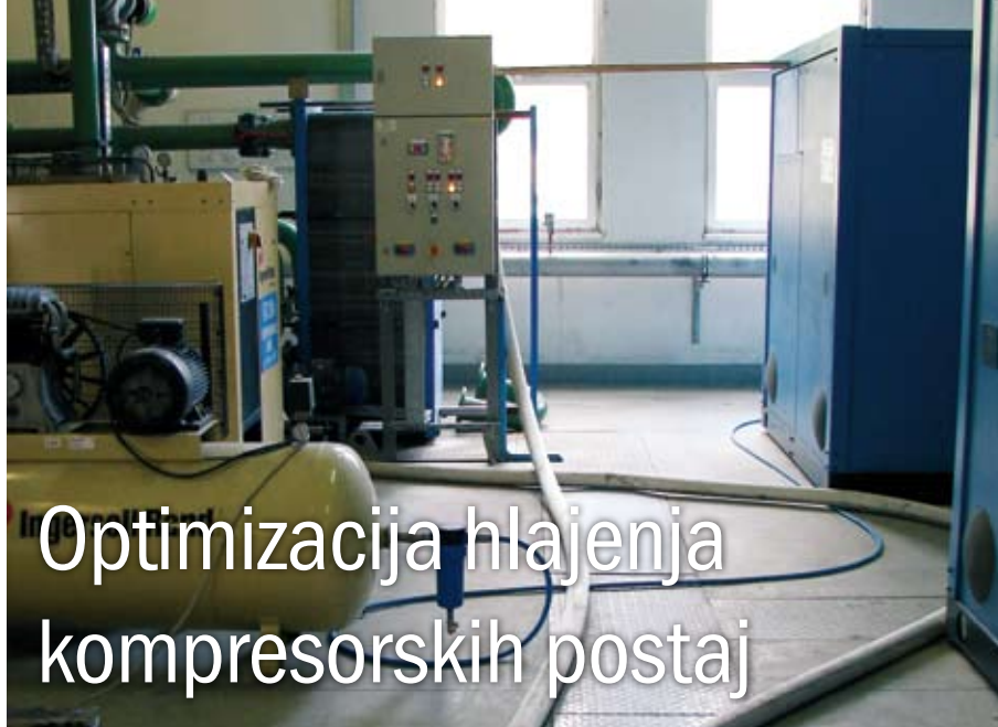
Industrijski testi hlajenja 7,5 barske kompresorske postaje
