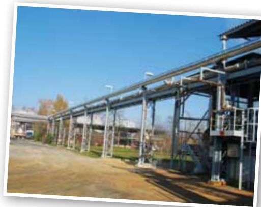
Pogled na rekonstruiran energetski most s parovodom med skladiščem žvepla in »S« kislino
