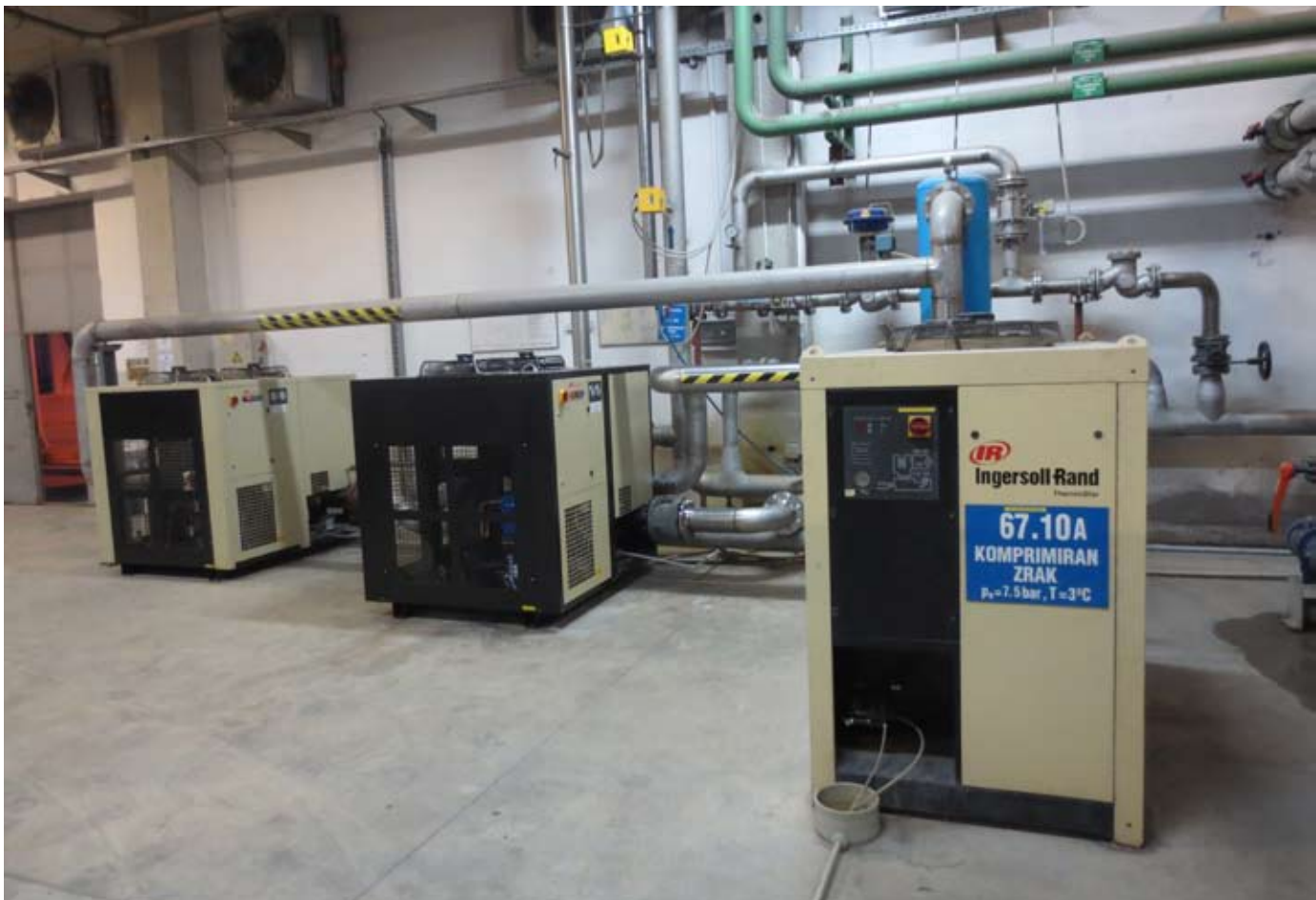
Sušenje komprimiranega zraka 7,5bar
