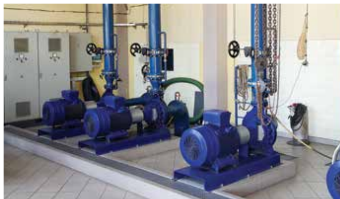
Strojnica s črpalkami, preko katerih se črpa voda iz reke Hudinje na proces priprave vode.
