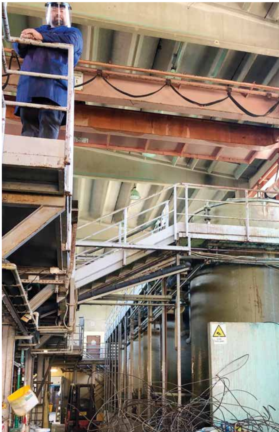
Obrat Modrega bakra, pogled na aeracijske stolpe v katerih poteka proces raztapljanja odpadnega bakra.
